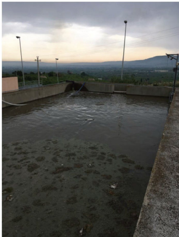
Figura 30 Vasca di pre-denitrificazione Linea 2.
