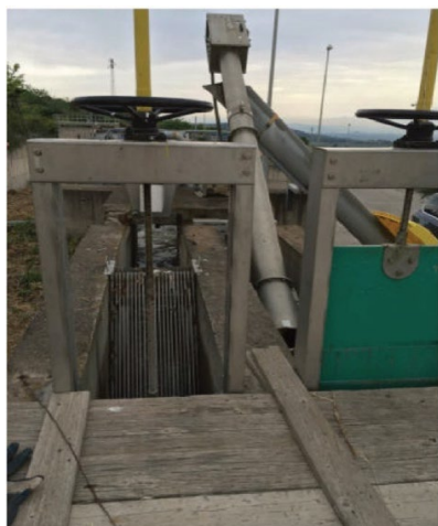
Figura 28 Canale di by-pass con grigliatura.
