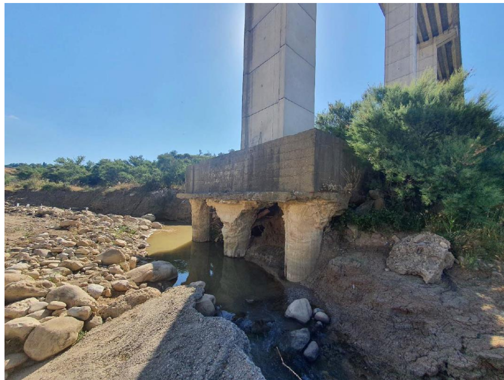
Foto n. 6 – situazione dello scalzamento a giugno 2022 (vista da valle)
