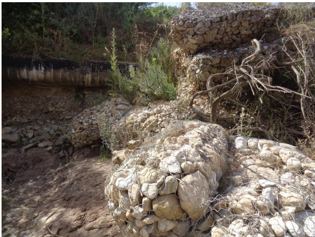
Foto n. 12 — gabbionate a protezione delle sponde e del tubo di adduzione idrica, crollate per erosione alla base
