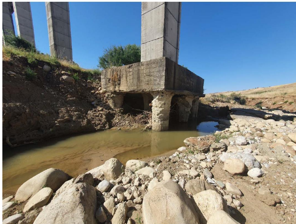
Foto n. 7 – situazione dello scalzamento a giugno 2022 (vista da monte)
