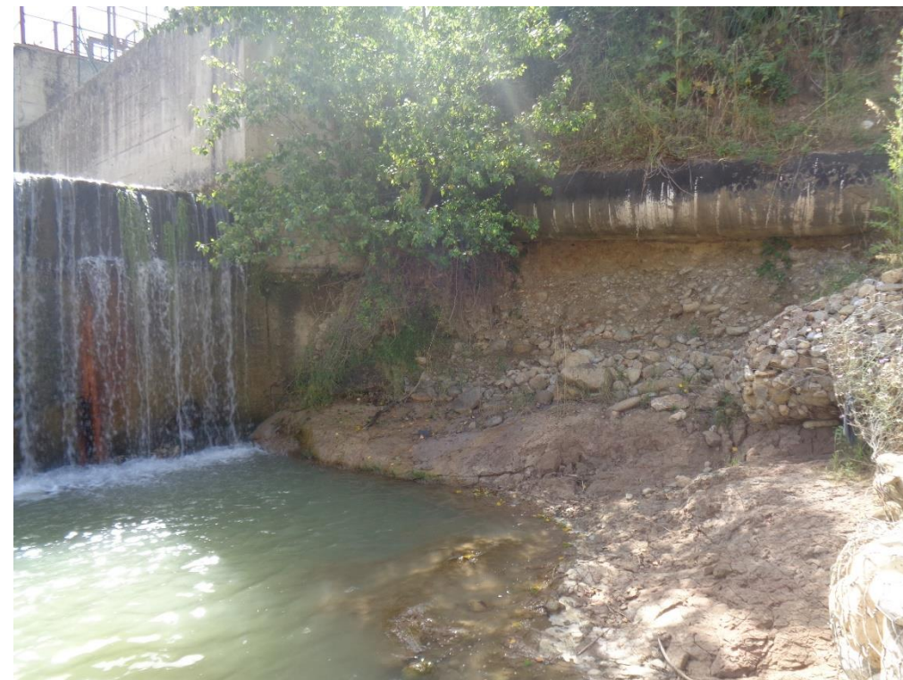
Foto n. 13 — particolare, in prossimità della soglia, del tubo di adduzione idrica rimasto scoperto dal crollo delle gabbionate poste a protezione
