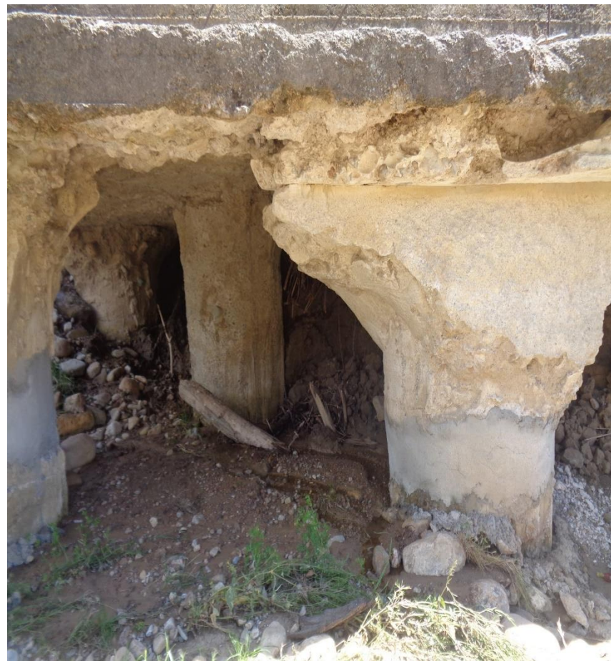
Foto n. 5 – particolare dello scalzamento
