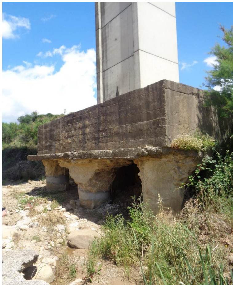
Foto n. 4 – particolare dello scalzamento
