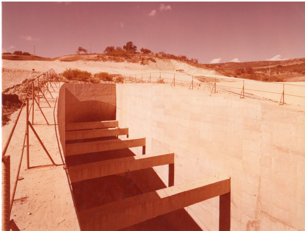
FIGURA 4-8 – FOTO SCATTATE DURANTE LA REALIZZAZIONE DELL'INVASO, CON OPERA DELLO SCARICO DI FONDO COMPLETATA
