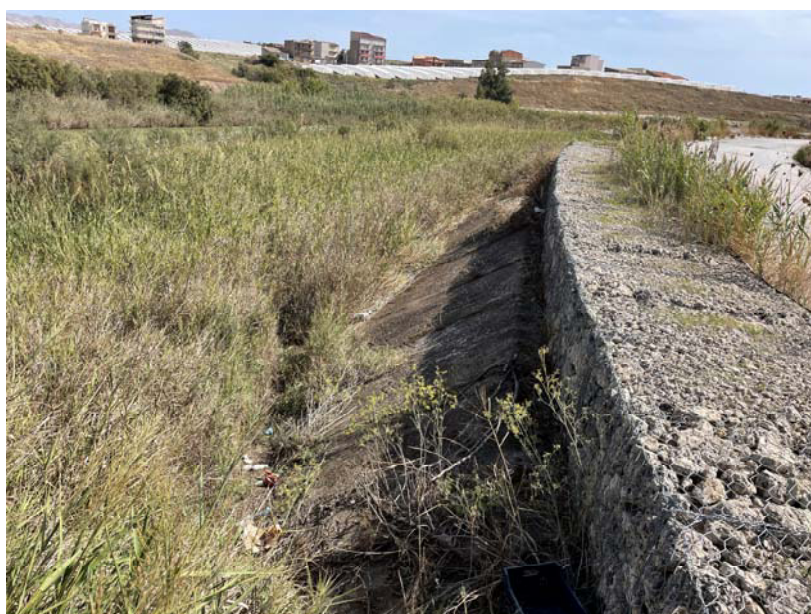
Figura 4.5 Opere Arginali esistenti: canale rivestito e gabbioni
