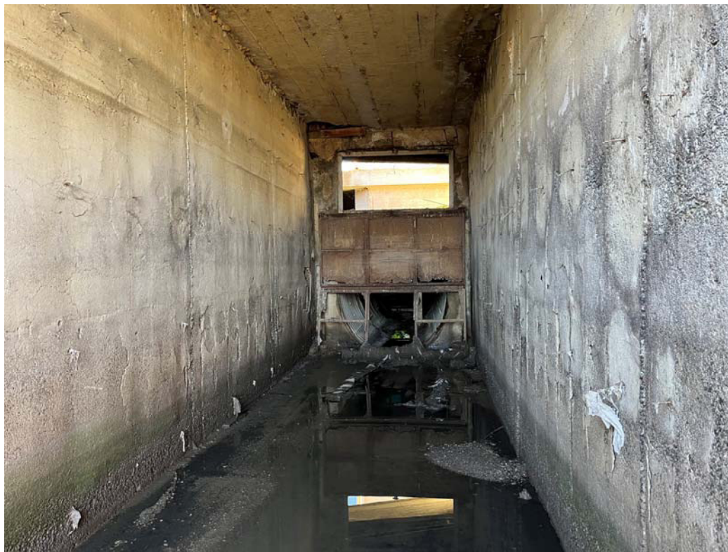
Figura 1.2 Manufatto di sbocco acque bianche via Honduras
