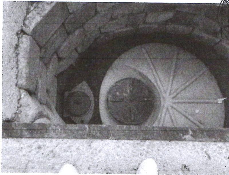
Foto 5 - Disoleatore con pozzetto dei prelievi
