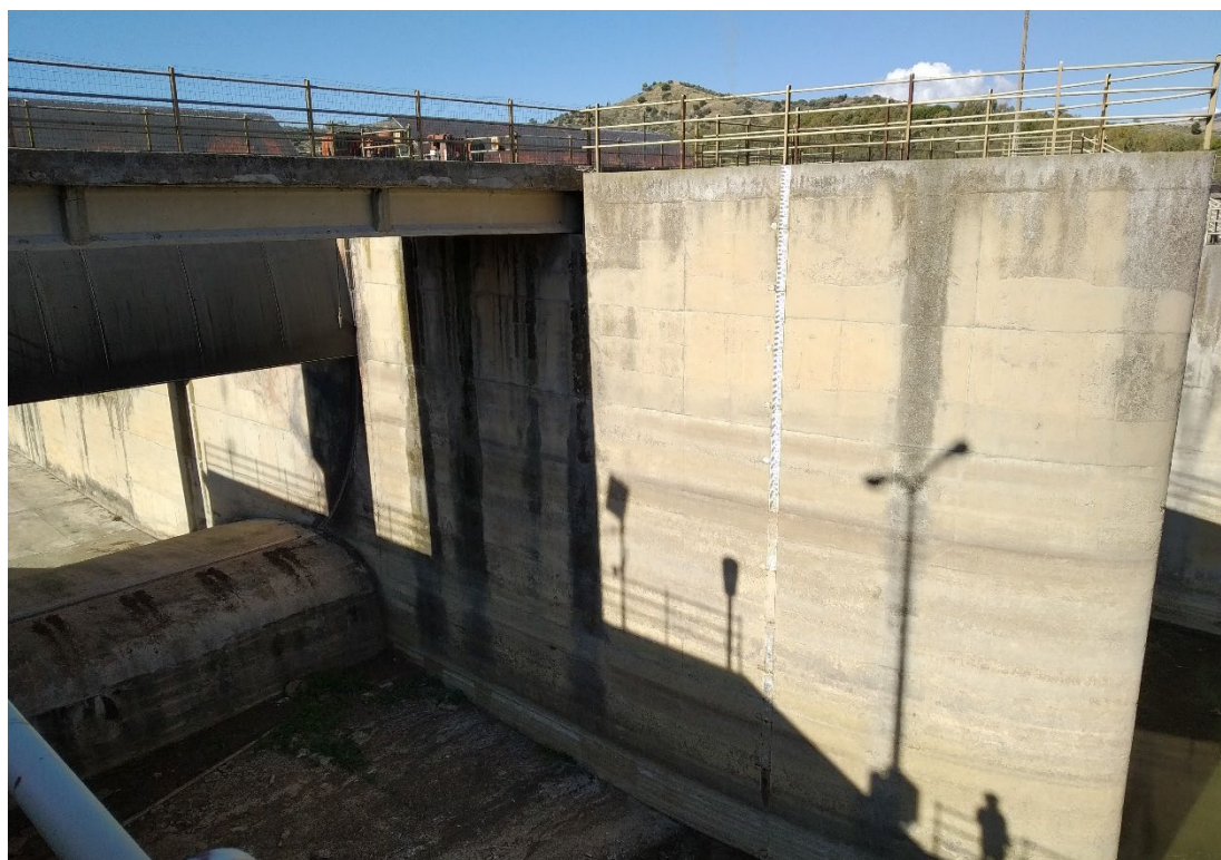
FIGURA 3-5 FOTO DELLO SCARICO DI SUPERFICIE.
