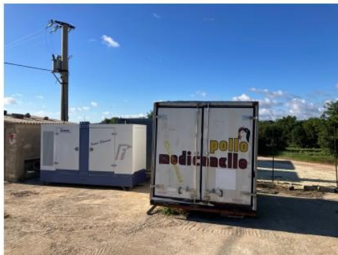
Cella frigorifera capannoni 3 e 4.
