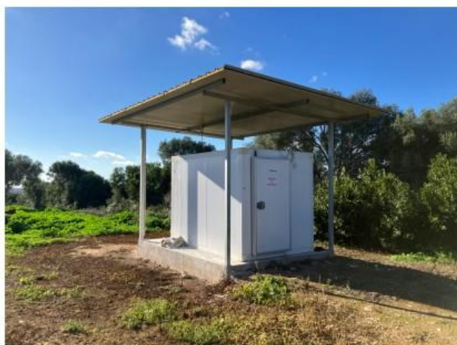
Cella frigorifera capannoni 1 e 2.
