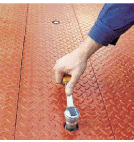
Accesso alle celle di carico grazie alla botola di ispezione
