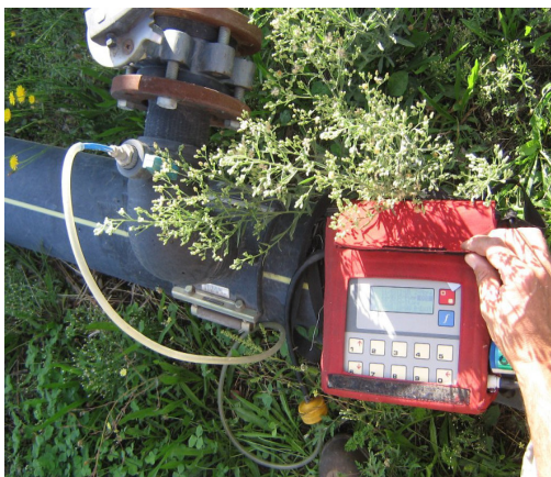
Particolare della misurazione della composizione del biogas mediante strumento dedicato
