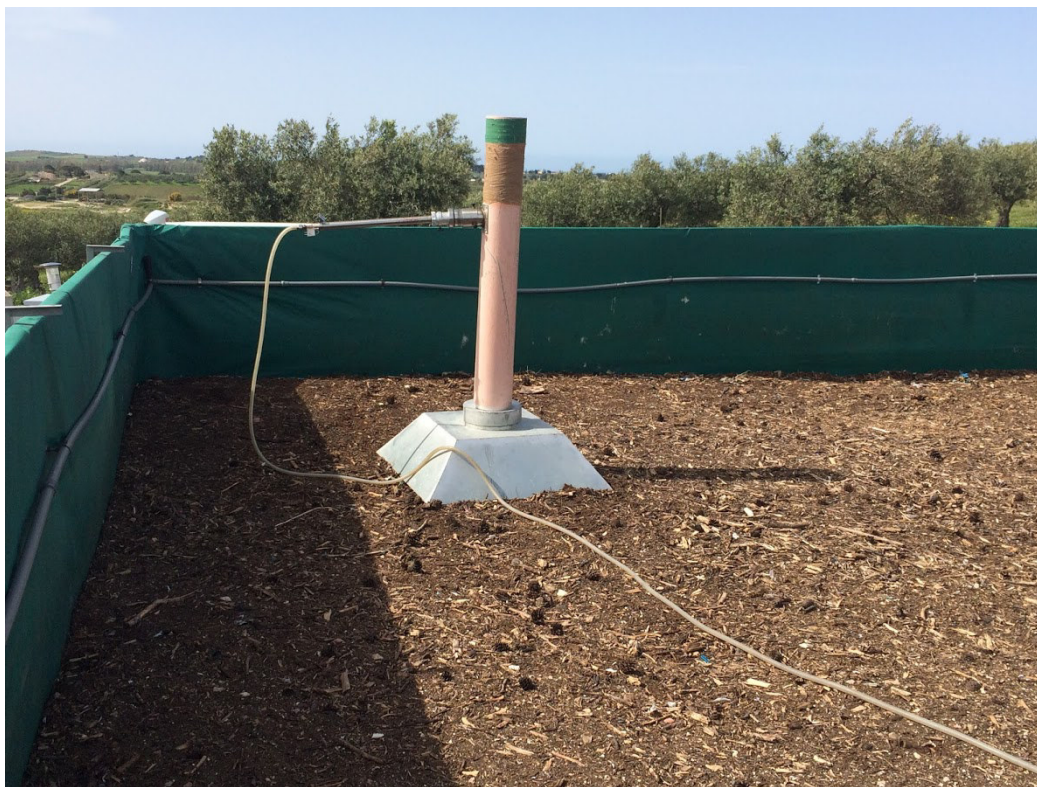
Particolare della cappa su letto biofiltro
