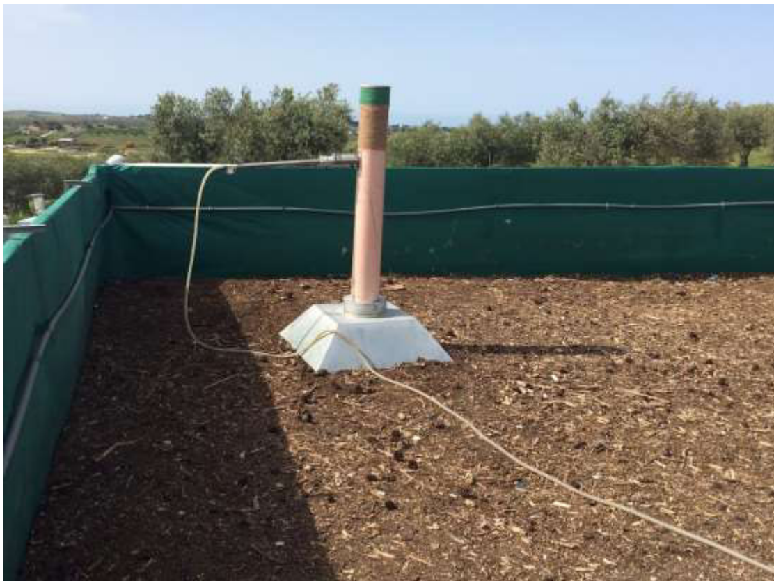
Particolare della cappa su letto biofiltro
